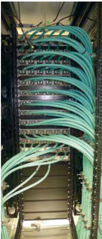
Bild 2. Verteilerschrank mit Easylan-H.D.S.-Trunk-Kabeln: Jede Leitung fasst sechs Datenverbindungen und soll Ordnung in dicht gepackte Verteilerschränke bringen.
