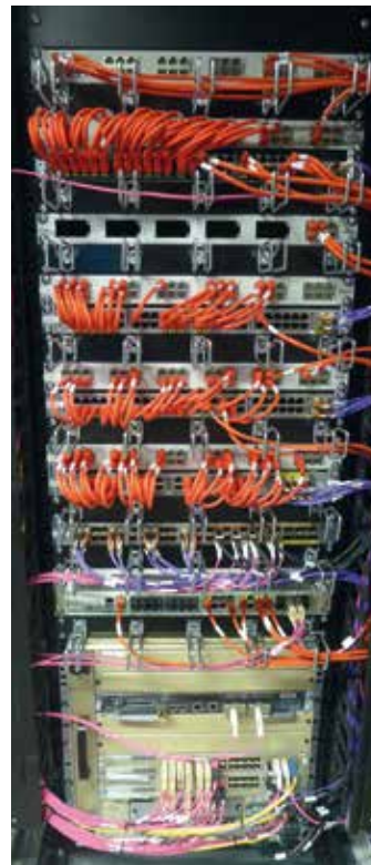
Bild 4. Beim Schrank mit dem Core-Switch nutzte das Planungsbüro Rucker und Schindele platzsparend zwei Patch-Ebenen: Die Kupferanbindung ist an der Frontseite ausgeführt.
