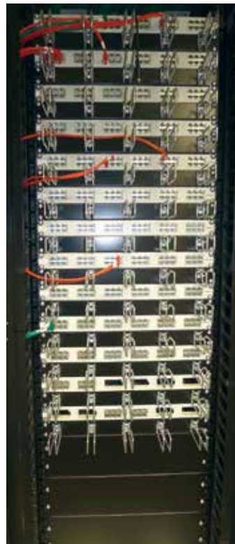
Bild 3. Die Anschlussmodule der Trunk-Kabel sind in Frontplatten mit entsprechenden Ausbrüchen geschraubt. Dies ergibt eine Packungsdichte von 36 Ports pro HE.
