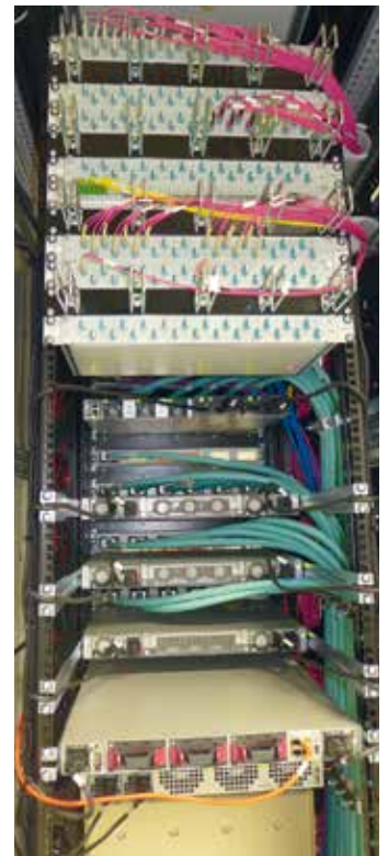
Bild 5. Die LWL-Kabel sind vom Switch in Kabelrohren zur rückwärtigen Patchebene geführt. So blieb die seitliche Lüftung davon weitgehend unbeeinflusst.
